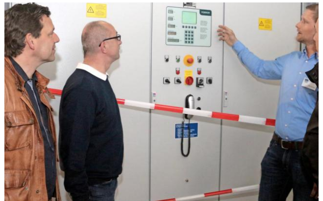
Ingenieur Timo Haueisen (2. v. r.) erklärt Rainer Stärzl (r.) und Uwe Auchter (2.v.l.) die Anzeige der Anlage 02 auf dem Horkenberg; links Investor Joachim Kruck.
