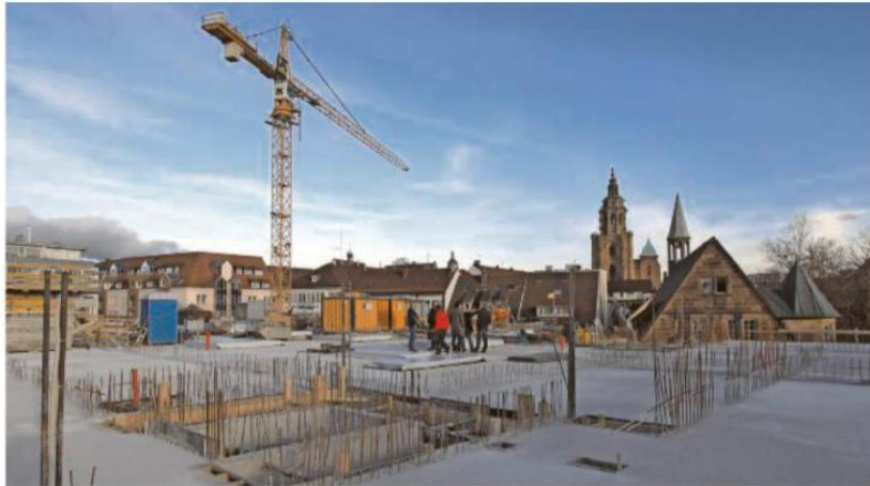
Wohnen mit Aussicht: Auf dieser 60 Zentimeter starken Betonplatte werden in den kommenden Monaten die drei Etagen mit mehr als 50 Wohnungen errichtet.
