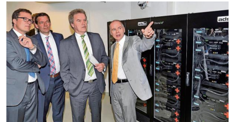
Der Batteriespeicher als Herzstück: (v.l.) Thomas Speidel (Firma adstec), Joachim Kruck, Minister Franz Untersteller und Kaco-Chef Ralf Hofmann. Foto: Mario Berger
